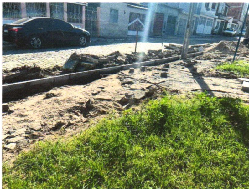
Foto 03 - ASSENTAMENTO DE GUIA (MEIO-FIO) EM TRECHO RETO, CONFECCIONADA EM CONCRETO PRÉ-FABRICADO, DIMENSÕES 100X15X13X20 CM (COMPRIMENTO X BASE INFERIOR X BASE SUPERIOR X ALTURA), PARA URBANIZAÇÃO INTERNA DE EMPREENDIMENTOS. AF_06/2016_P
